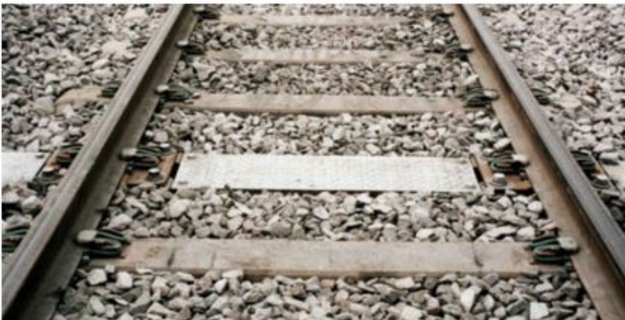
Figure 2.58: Vista general de traviesa cajón instalada en vía
