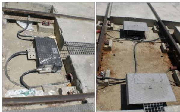
Figure 2.159: Unidades de sintonía TI-21 de Bombardier instaladas en vía estuchada
