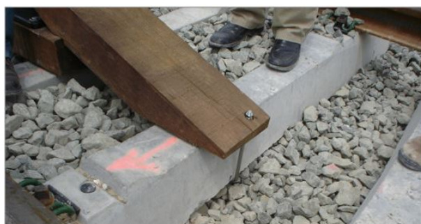
Figure 2.157: Sistema habitual de anclaje de baliza ASFA a traviesa
