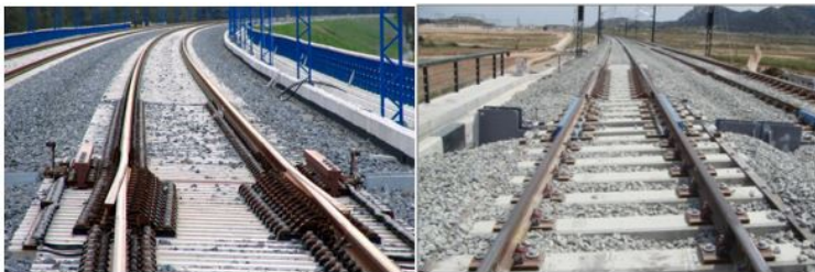
Figure 3.74: Vista general de aparato de dilatación montado en vía sobre balasto
